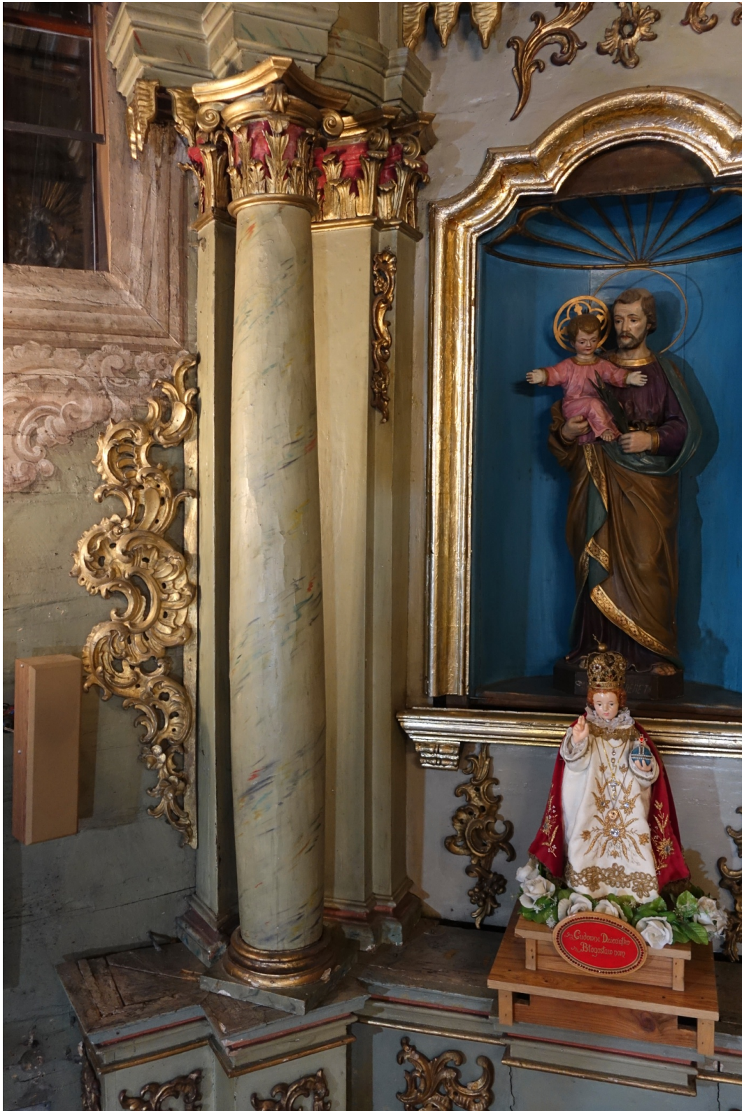
Fot.8. Sławęcín, kościół p.w. św. Katarzyny, ołtarz boczny lewy. Stan przed konserwacją. Widoczne m.in. spękania i wyrzuszenia zapraw wraz późniejszymi warstwami na trzonie kolumny.
