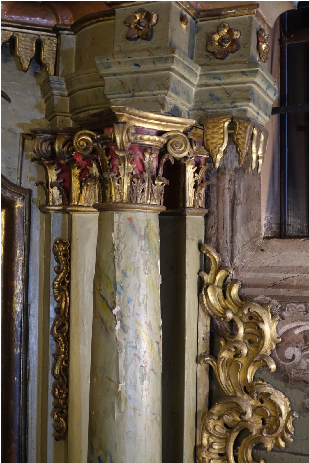
Fot.24. Sławęcin, kościół p.w. św. Katarzyny, ołtarz boczny prawy. Stan przed konserwacją. Widoczne m.in. spękane i wybrzuszone warstwy na trzonie kolumny.
