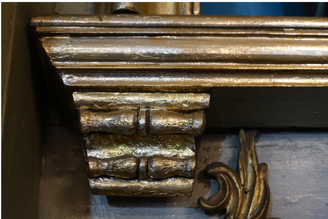
Fot.13 i 14. Sławęcin, kościół p.w. św. Katarzyny, ołtarz boczny lewy. Stan przed konserwacją. Widoczna m.in. „pomarszczona” warstwa szlagmetal, będąca wynikiem błędów technologicznych.
